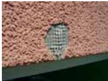
Poškození omítky v místě spoje
