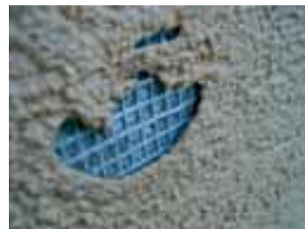
Defekt v důsledku slabé armovací vrstvy
